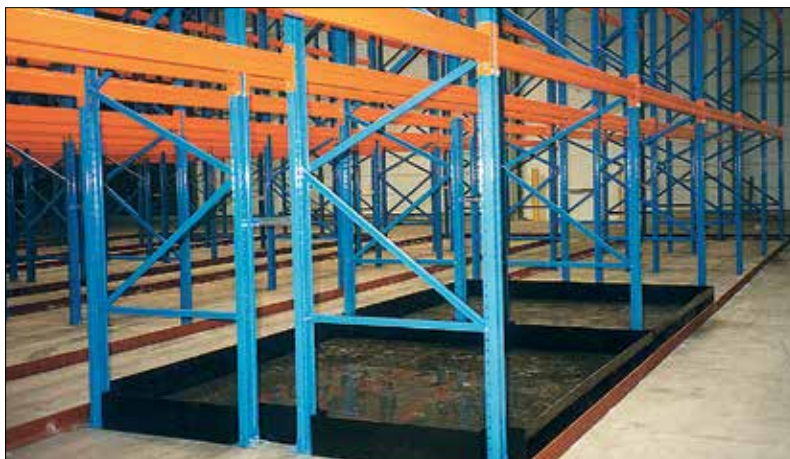
Equipamentos de retenção, ajustados a racks neste armazém de paletes.
